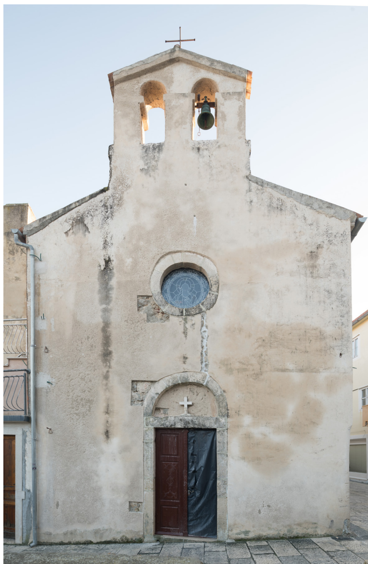
Crkva sv. Antuna Padovanskog, Rab. Glavno pročelje. Stanje nakon ugradnje zatega i sanacije pukotina. Snimka: K. Gavrilica, 2025.
