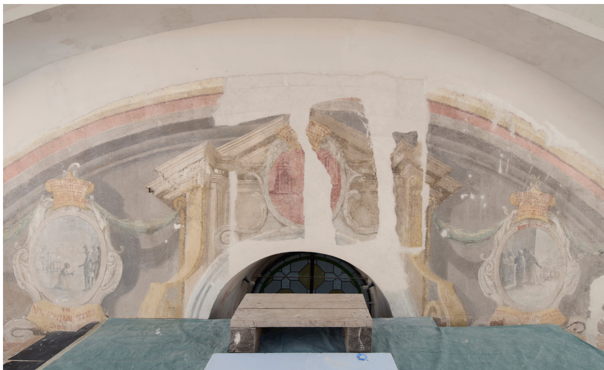
Jastrebarsko, crkva sv. Nikole. Luneta zapadnog zida pjevališta. Stanje prije radova. Snimka: K. Gavrilica, 2024.
