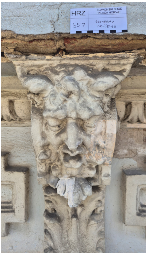
Slavonski Brod, palača Horvat. Sjeverno pročelje. Restauratorske sonde na antropomorfnoj konzoli zaključnog vijenca. Snimka: M. Krizman, 2025.
