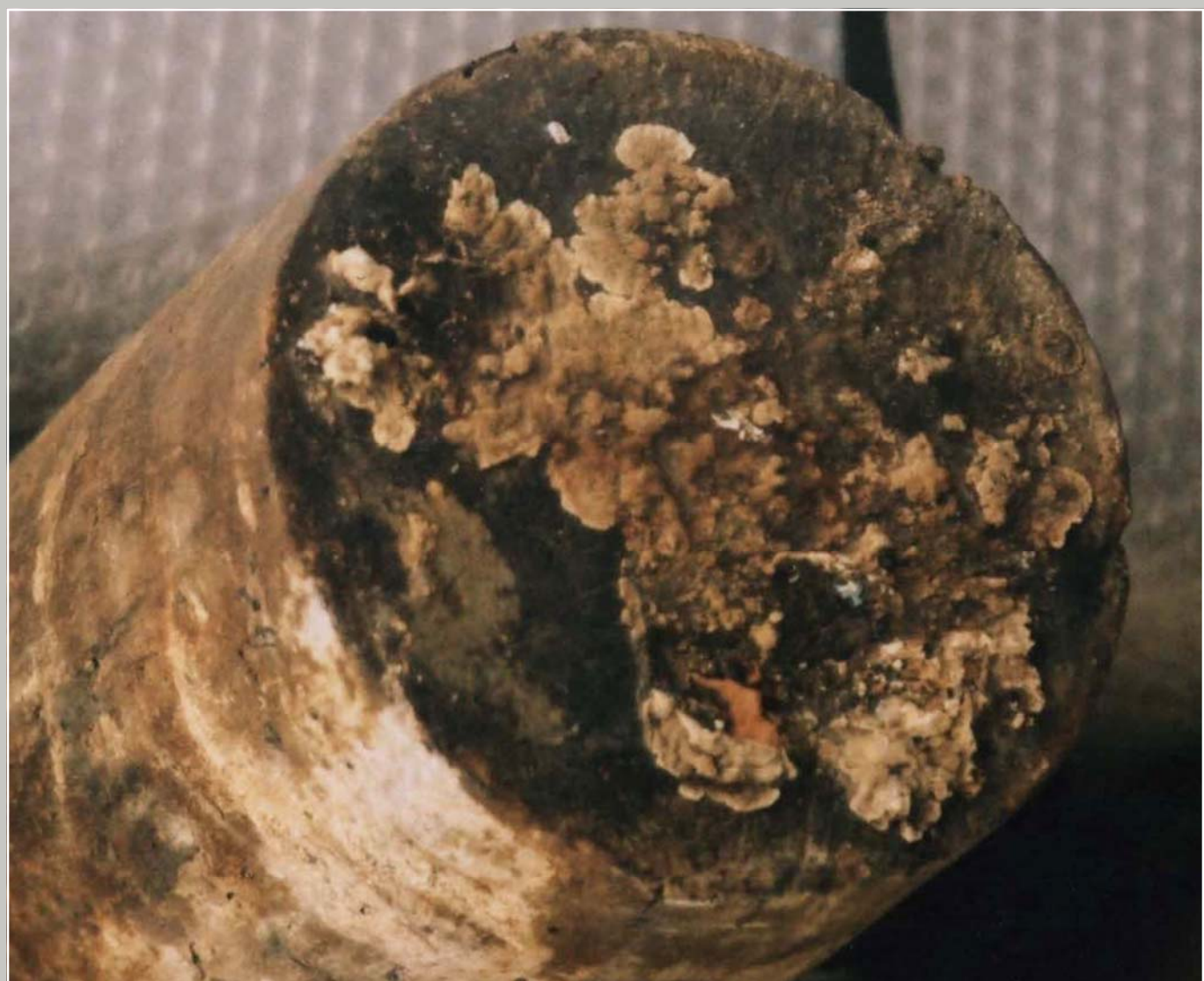
Plijesan i gljivice na dijelu stupa / Mould and fungi on the top of the column
