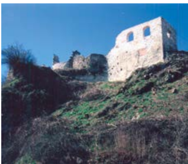
Slika 29. Četverokutna sjeveroistočna kula nakon sanacije i rekonstrukcije otvora, 2008. godine (fototeka HRZ-a, snimila N. Vasić).
