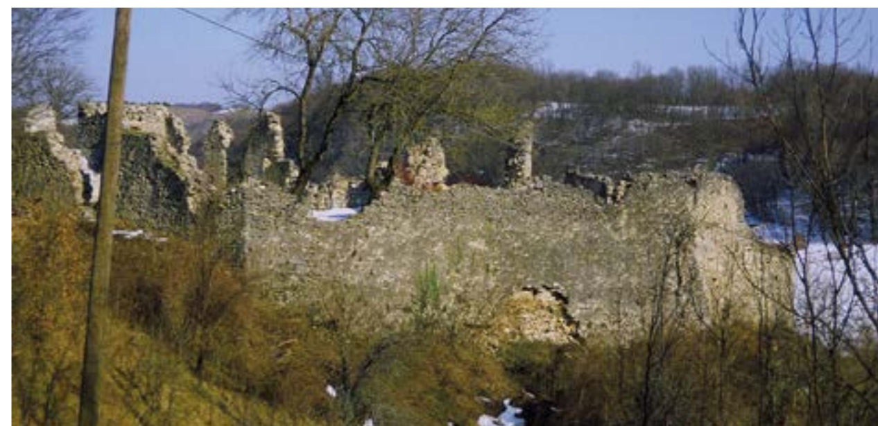
Slika 31. Pogled na zapadni zid grada, vidljiva su znatna oštećenja lica zida, 2003. godine (fototeka HRZ-a, snimila V. Milošević).
