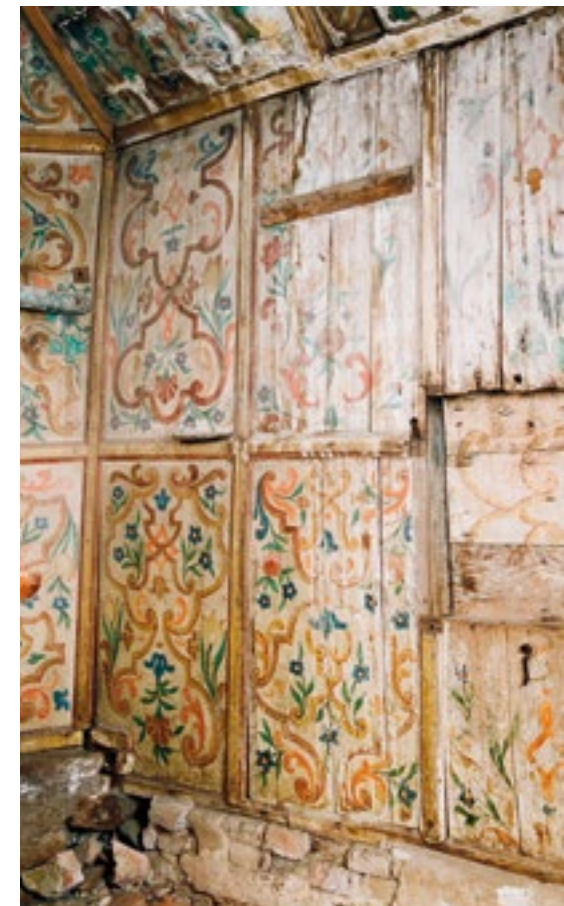
Pogled na južnu stranu svetišta prije konzervatorsko-restauratorskih radova. Snimio: V. Barac, 2001. Fototeka HRZ-a.
