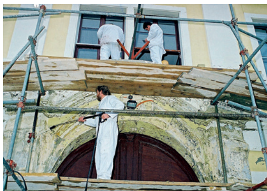
Sanacija kamenih elemenata na pročelju Improvement of the stone elements on the façade
