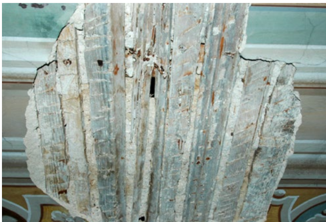
Motovun, crkva sv. Stjepana, otpala oslikana žbuka sa stropa (snimka: B. Orbanić, 2007.) Motovun, Church of St. Stephen, painted plaster falling off the ceiling (photo: B. Orbanić, 2007)
