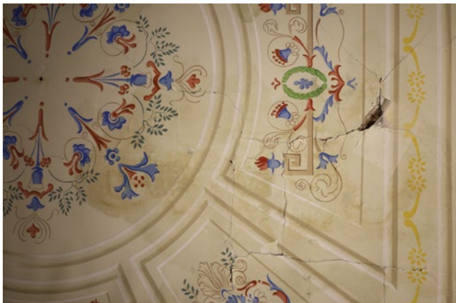
Zagreb, Palača Drašković, Opatička 18. Ilirska dvorana – detalj oštećenja na stropu (snimka: A. Dumbović, 2024.)
