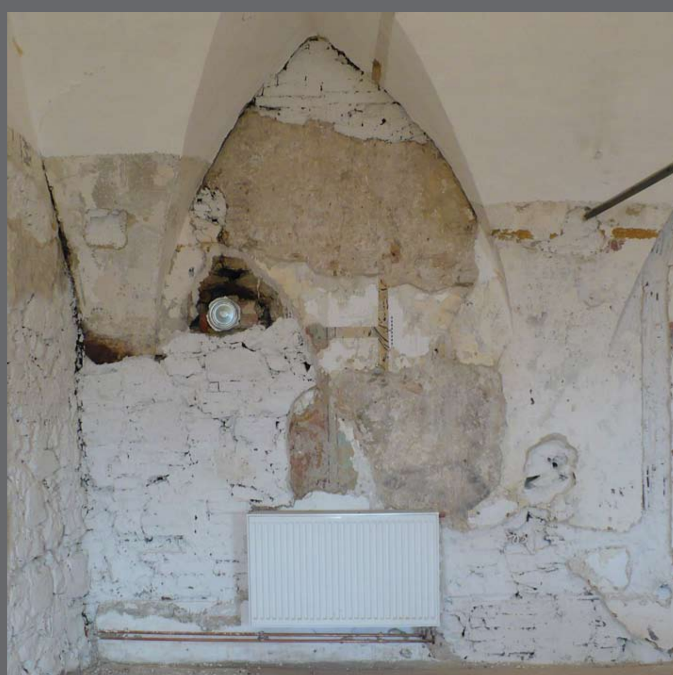
Sjeverno krilo, prvi kat, srednja prostorija, dio južnog zida tijekom uklanjanja naknadnih žbukanih i ličenih slojeva.
