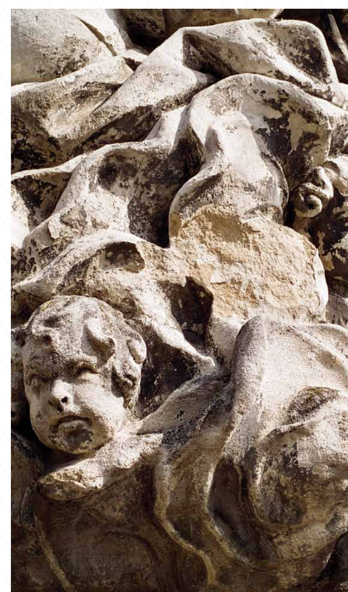
Oštećenja kamenih dijelova na vrhu spomenika Damages of stone at the top of the monument
