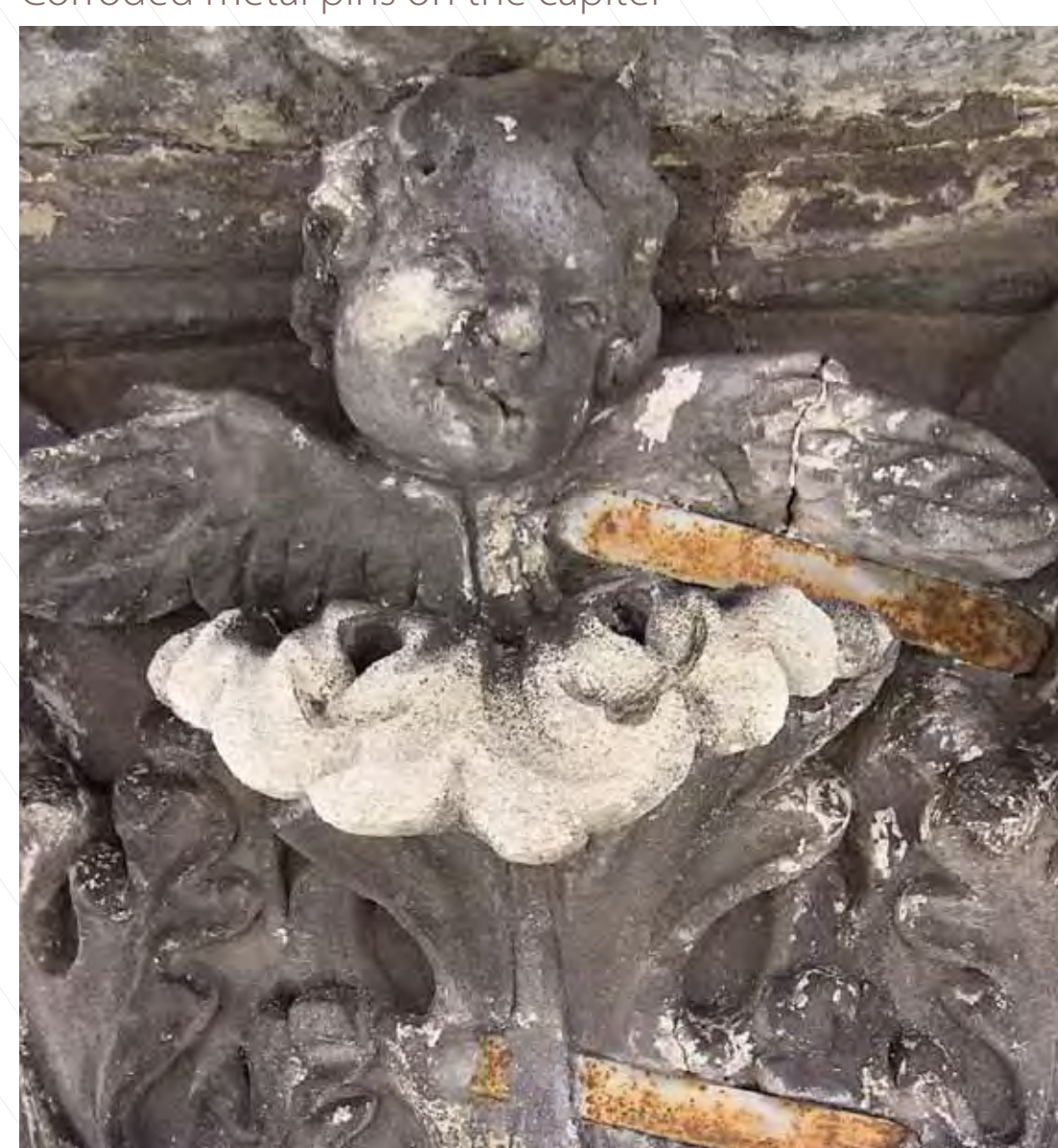
Korodirane željezne klanfe na kapitelu Corroded metal pins on the capitel
