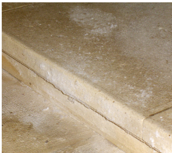
7. Eflorescencija ili inkrustacija? (snimio H. Malinar) Efflorescence or incrustation? (photo by H. Malinar)
