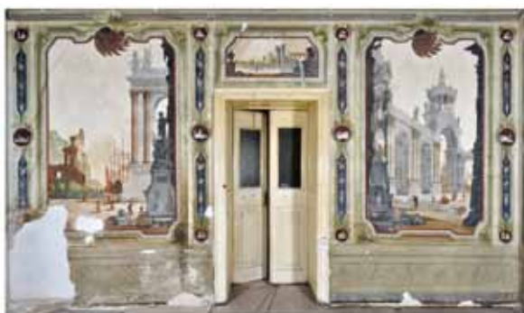
Drugi kat upravne zgrade bivše rafinerije šećera, prostorija 21, pogled na sjeverni zid
