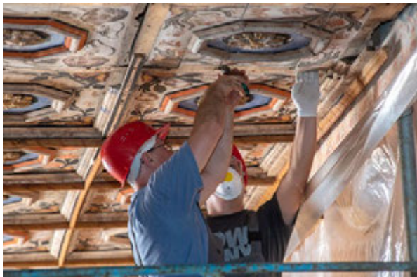
10. Demontaža drugog dijela tabulata (arhiva HRZ-a, snimka: J. Kliska, 2018.) Disassembly of the second part of the wooden ceiling (HRZ Archive, J. Kliska, 2018)
