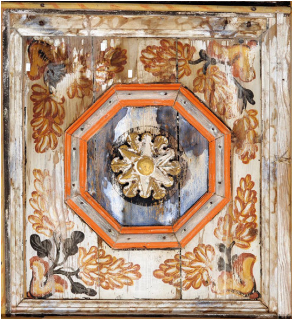
3. Beram, crkva sv. Marije na Škrilinah, tabulat, detalj tabulata s oštećenjima snimljen tijekom konzervatorsko-restauratorskih istraživanja (arhiva HRZ-a, snimka: J. Kliska, 2015.)
