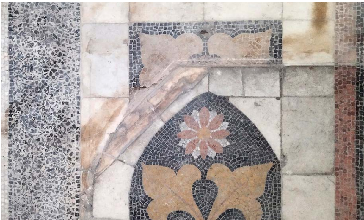
14. Pogled na mozaik i teraco pod s vidljivom naknadnom intervencijom i preoblikovanjem mozaika, istočni dio svetišnog prostora (arhiva HRZ-a, snimka: T. Šaina, 2022.)
