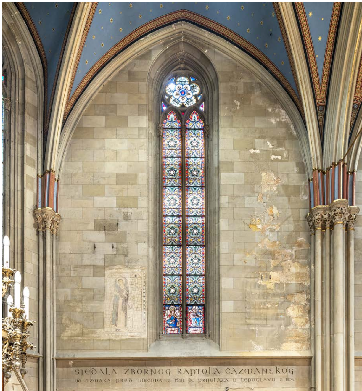
7. Unutarnji južni zid broda crkve sa zonama naliča koji se osipa (arhiva HRZ-a, snimka: K. Gavrilica, 2022.) Inner south wall of the nave with areas of flaking facing (HRZ Archive, K. Gavrilica, 2022)
