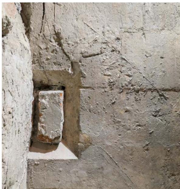
3. Djelomično odzidan prozor u podu pjevališta preko kojega se vidi otisak svoda pjevališta iz vremena biskupa Alagovića (arhiva HRZ-a, sondirali: M. Jelenčić, M. Deak, snimka: K. Gavrilica, 2024.) Partially bricked-up window in the choir floor through which the imprint of the choir vault from the time of Bishop Alagović can be seen (HRZ Archive; probe: M. Jelenčić, M. Deak; photo: K. Gavrilica, 2024)
