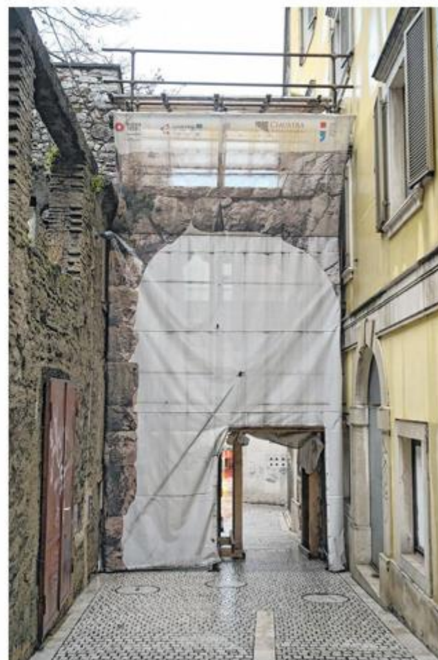
Do statičke sanacije još nije došlo
