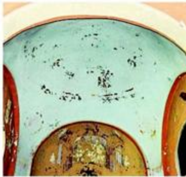
Zatečen prebojan svod 2008.
