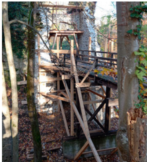
Podgarić, Stari grad Garić-grad, potporno-zaštitna skele i obrambeni zid kod ulaza u grad. Snimka: T. Kučinac, 2023.
