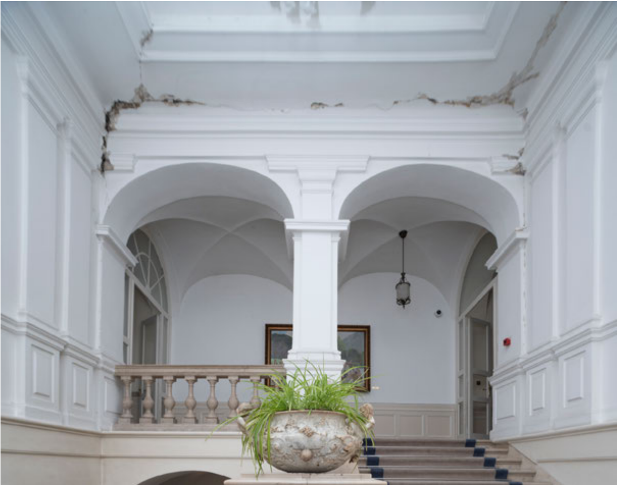
Zagreb, Banski dvori – glavno stubište. Pukotina u gornjem dijelu istočnoga zida stubišta nakon potresa, prije početka konzervatorsko-restauratorskih radova. Snimka: I. Marinković, 2021.
