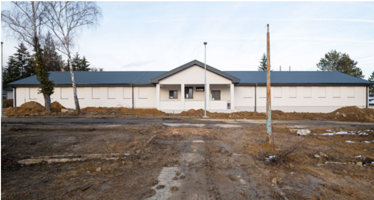
Jastrebarsko, bivša Vojarna „Dr. Ante Starčević“ (zgrade 2, 3, 4, 5, 6, 7 i 63). Zgrada 5, južno pročelje, nakon izvedenih radova. Snimka: G. Tomljenović, 2023.
