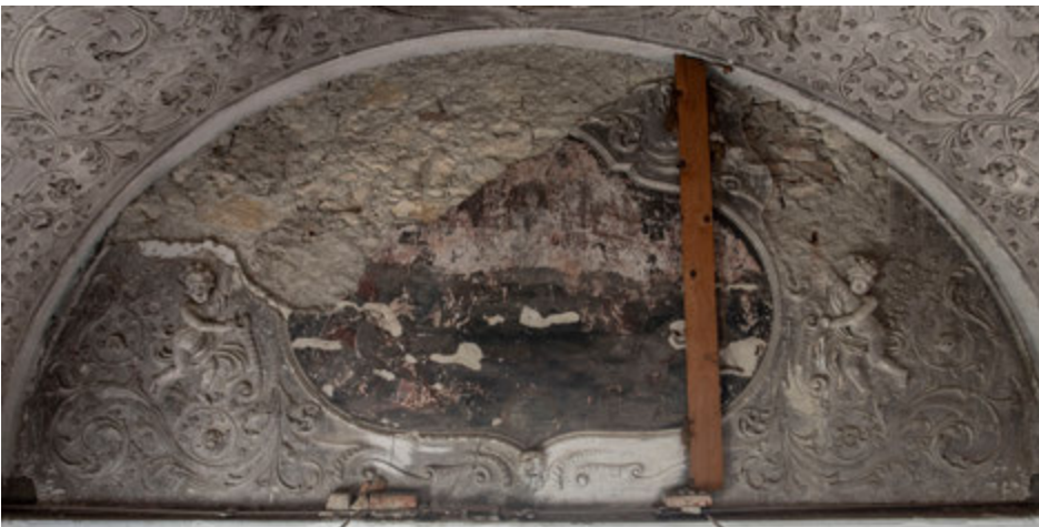
Lepoglava, bivši pavlinski samostan i župna crkva Bezgrešnog začeća Blažene Djevice Marije – bivša knjižnica. Zapadna luneta prije početka konzervatorsko-restauratorskih radova. Snimka: J. Kliska, 2018.
