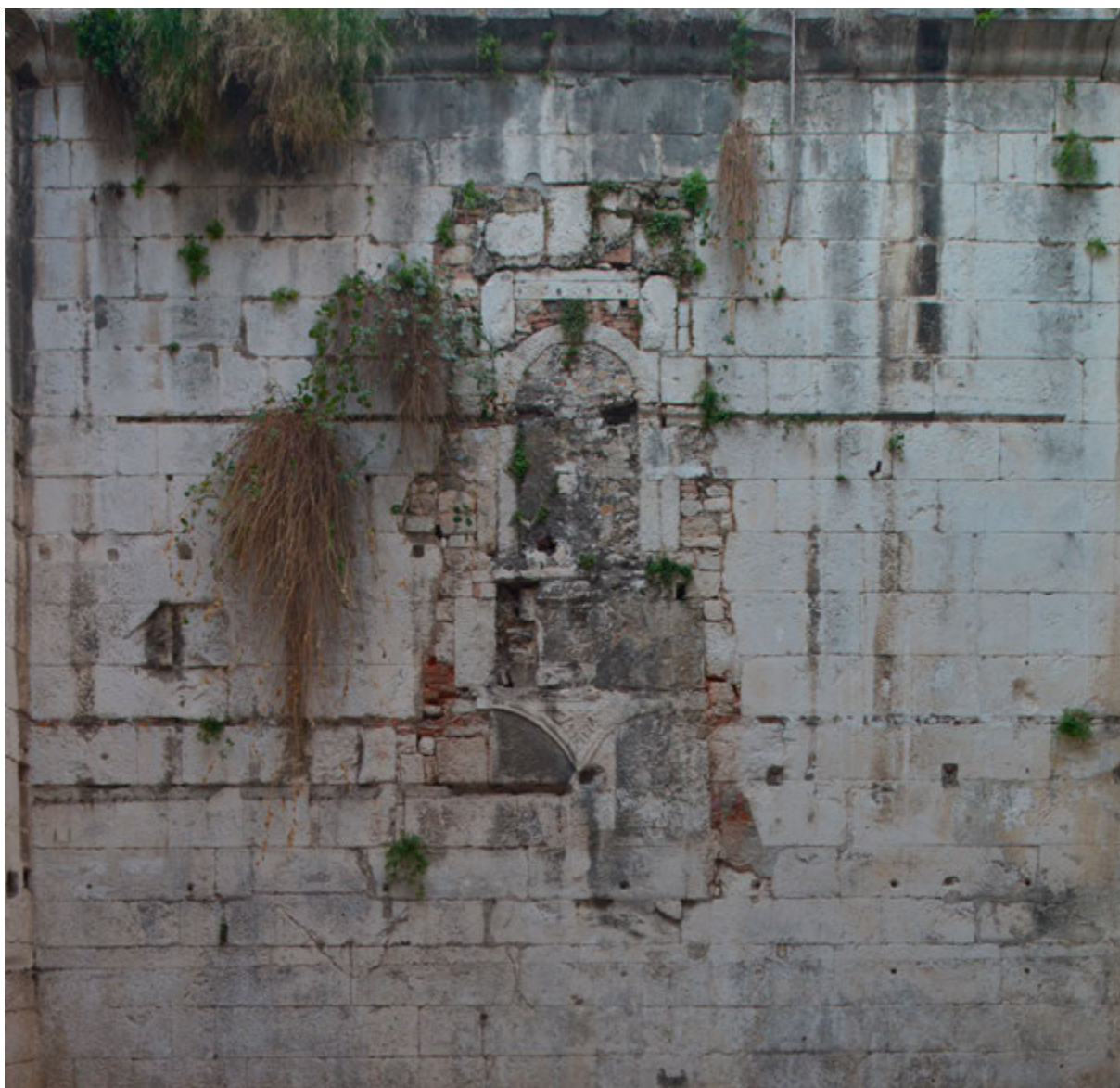
Split, Dioklecijanova palača, Zapadna vrata s crkvom Gospe od Zvonika. Zatečeno stanje sjevernog zida propugnakula. Snimka: P. Gamulin, 2021.
