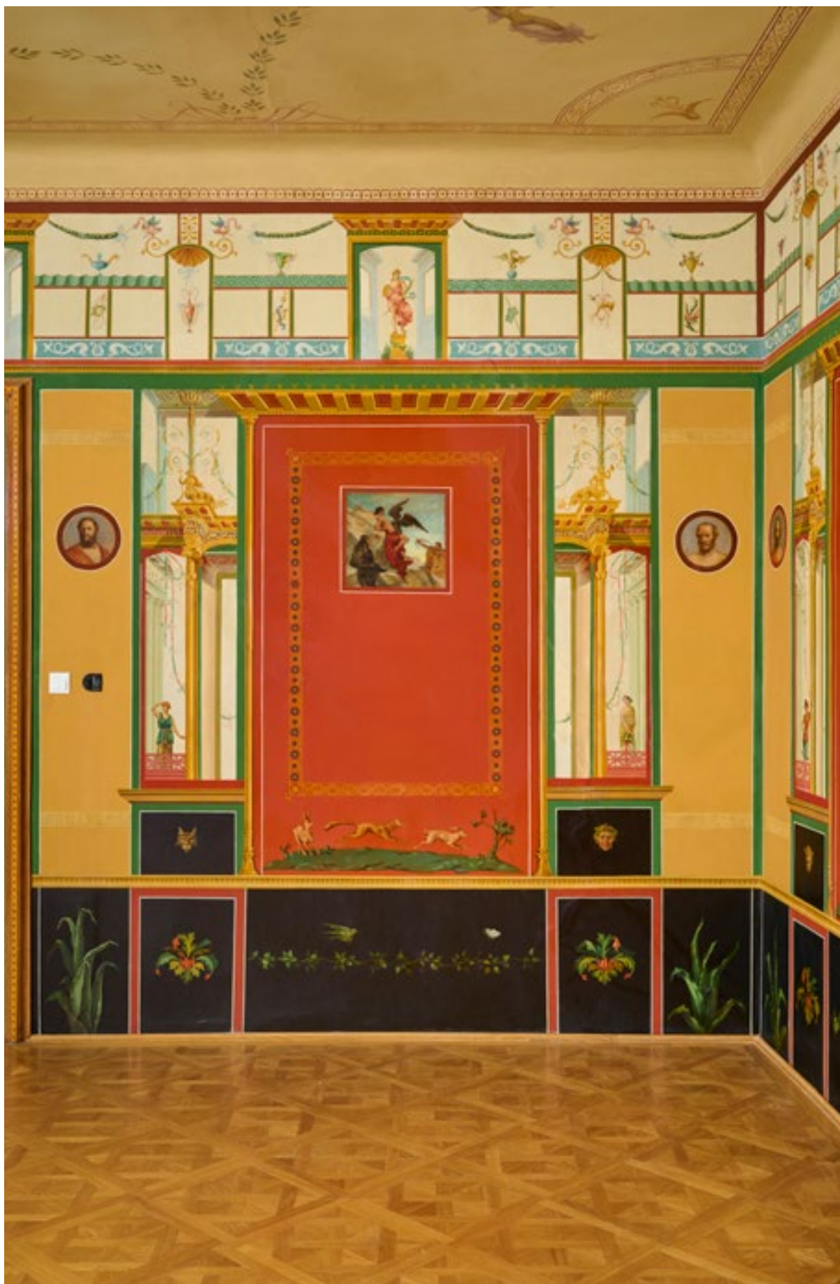
Zagreb, Opatička 10, Palača bogoštovlja i nastave. Pompejanska soba. Zidni oslik sjevernog dijela zapadnog zida nakon radova. Snimka: Lj. Gamulin, 2024.
