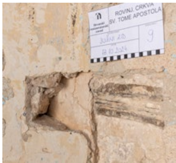
Rovinj, crkva sv. Tome apostola, ulični prolaz. Detalj južnog zida – naliči i žbukani slojevi ispod zazida i recentnih žbuka i naliča. Snimka: I. Marinković, 2024.
