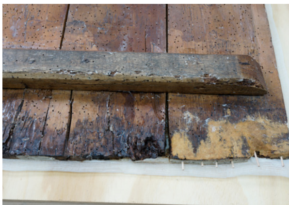
5. Prijašnja intervencija kojom se pokušao armirati degradirani dio nosioca drvenim štapićima (fototeka HRZ-a, snimio O. Šuman, 2016.)
