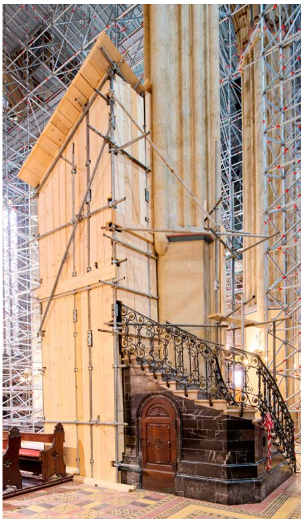
8. Propovjedaonica, zaštita in situ neposredno nakon potresa 2020. (arhiva HRZ-a, snimka: Lj. Gamulin, 2022.) Pulpit, in situ protection after the earthquake (HRZ Archive, Lj. Gamulin, 2022)
