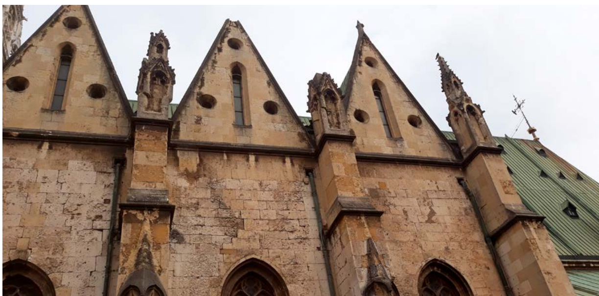
5. Južno pročelje: srušeni ukrasni elementi kamenih ruža s vrha timpanona krovnih kućica i vrh baldahina na kontraforu; vidljive su pukotine zida iznad prozora (fototeka GZZSKP-a, 2020.)
