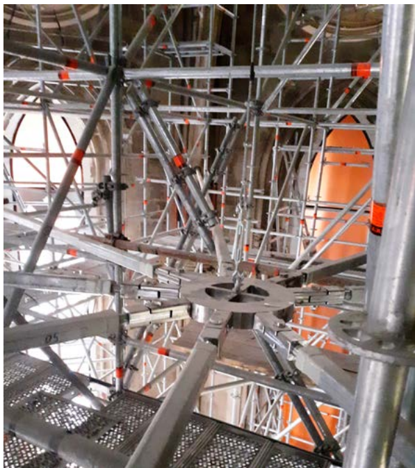
15. Sustav zatega u apsidi: zrakasto postavljene čelične zatega spojene na središnji disk (fototeka GZZSKP-a, 2023.) Bracing system in the apse: radially-arranged steel bracing connected to a central disk (GZZSKP Photo Archive, 2023)
